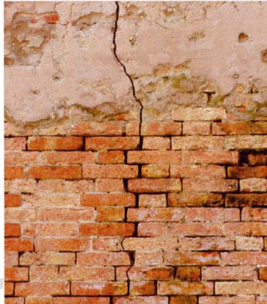
Figura 64. Paramento murario danneggiato su cui verrà realizzato intervento di scuci e cuci
